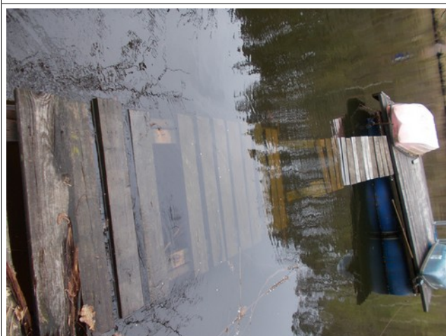
lávka částečně nemá prkna a je pod vodou
